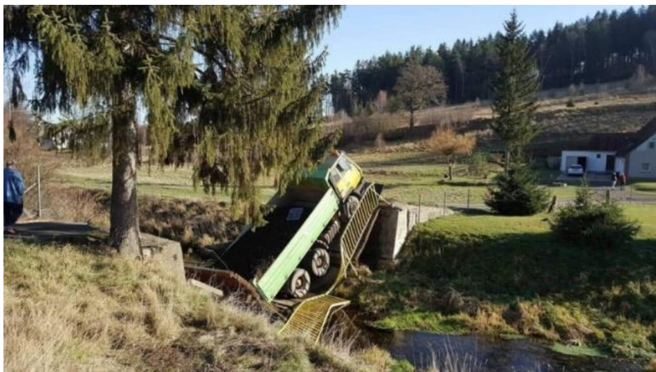
Rys. 13. Załamanie drewnianego mostu w Starej Kamienicy pod samochodem ciężarowym [31].
