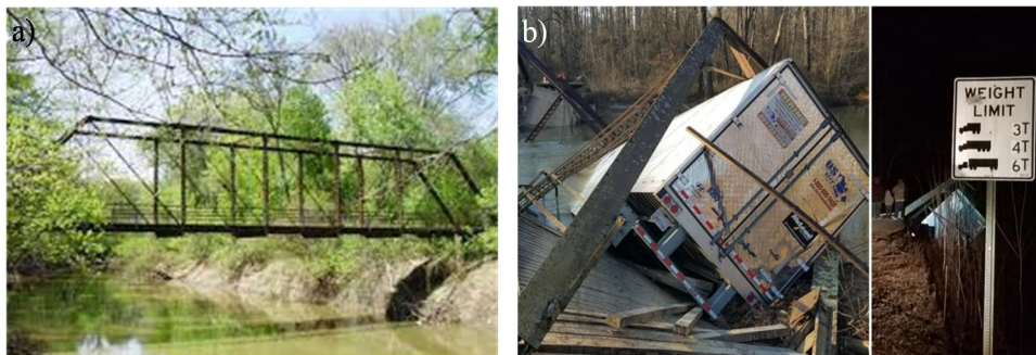
Rys. 16. Most Dale Bend na rzekę Jean, Ola, Arkansas, USA: a) widok mostu przed katastrofą; b) skutki katastrofy wskutek przeciążenia konstrukcji, znacznie przekraczającego dozwoloną masę pojazdów [34].
