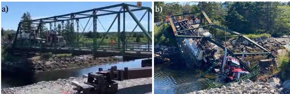
Rys. 17. Most Tittle, Canso, Nova Scotia, Kanada: a) podczas transportu dźwigu przez most tuż przed zawaleniem obiektu; b) skutki katastrofy [35].
